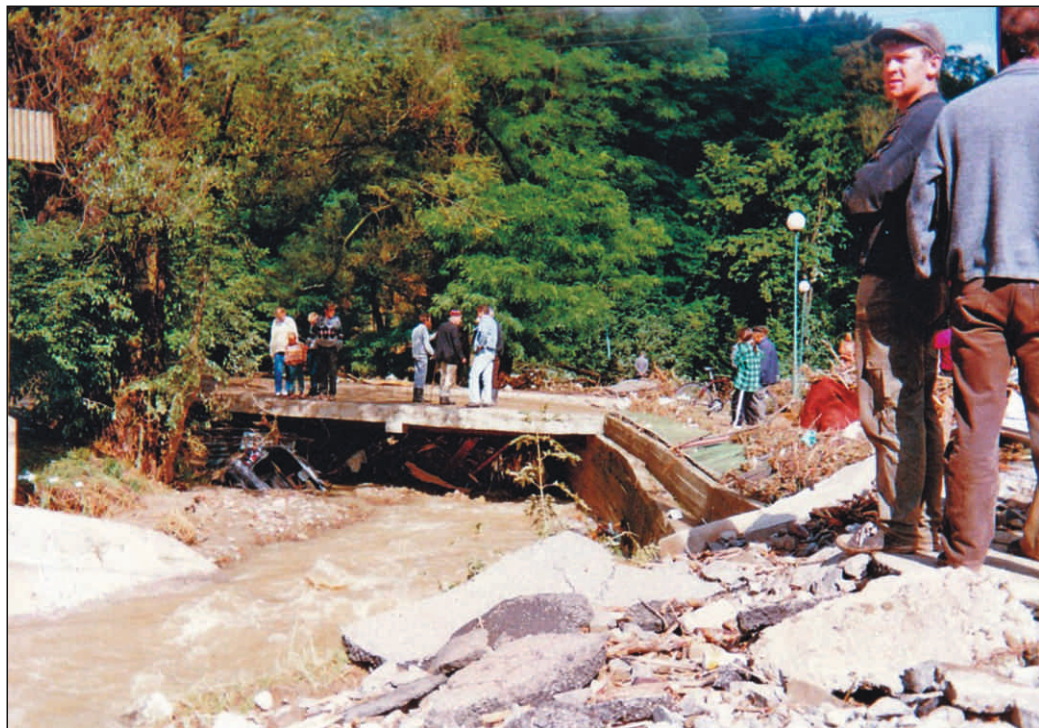
Zniszczenia po przejściu wód powodziowych
