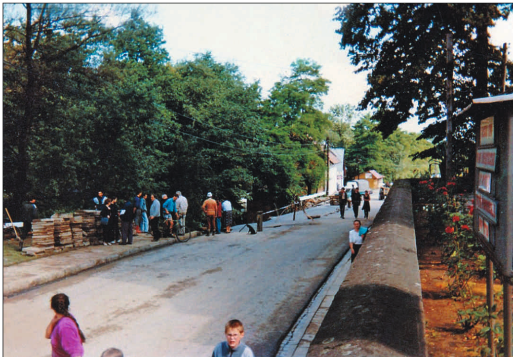
Wyrwa w brzegu potoku obok kościoła - uszkodzona droga
