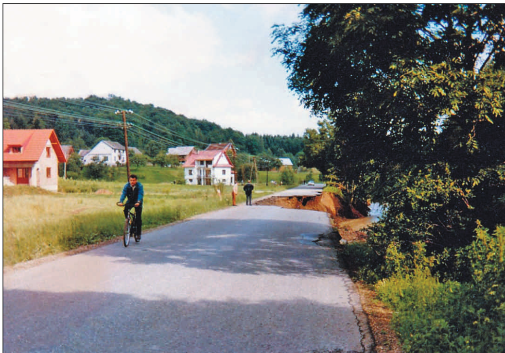
Zniszczona droga powiatowa po przejściu wysokiej wody
